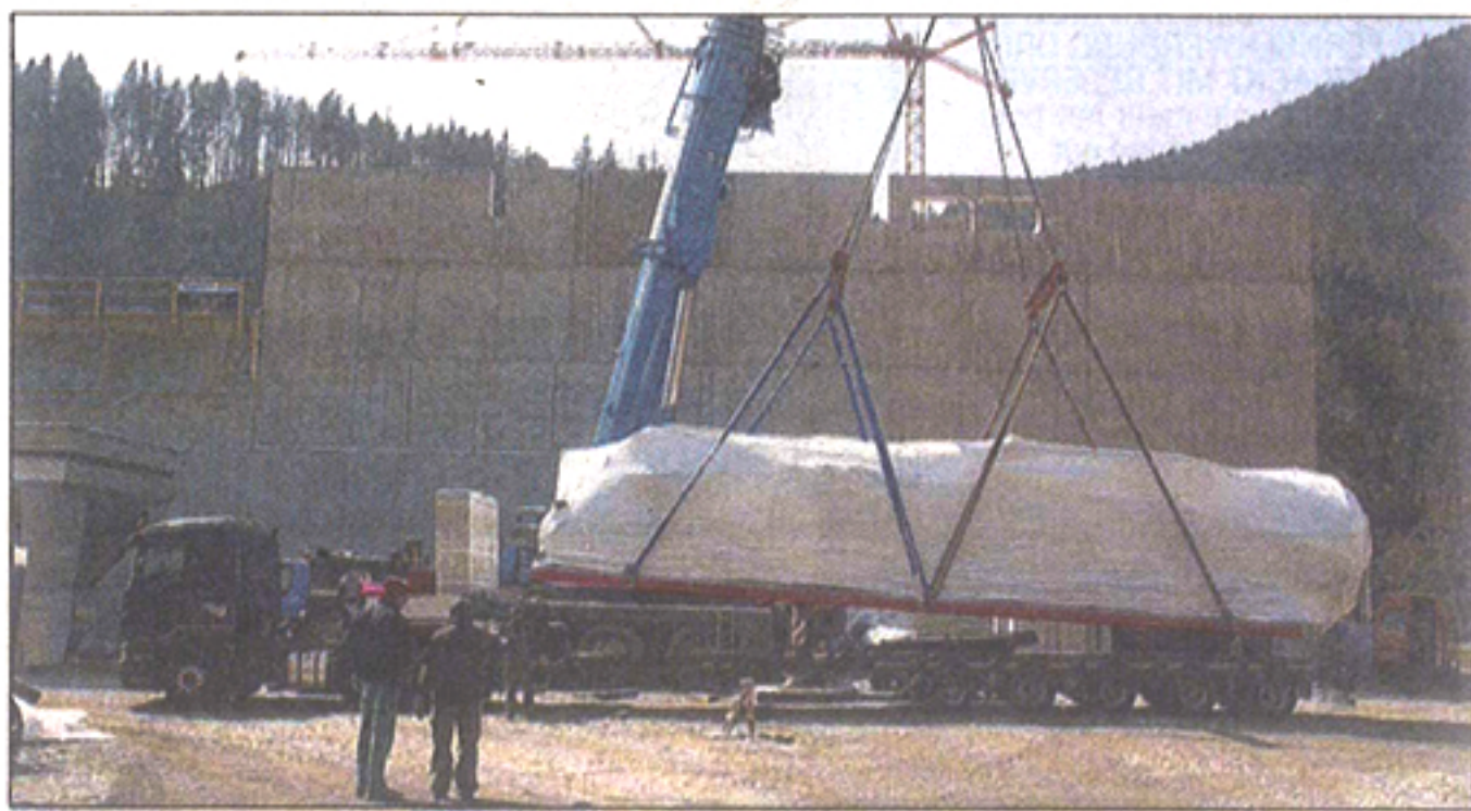
Das ORC-Modul ist das Herzstück für die Produktion von Ökostrom im Naturwärme-Heizkraftwerk Montafon. (Foto: mbs/Huber)
