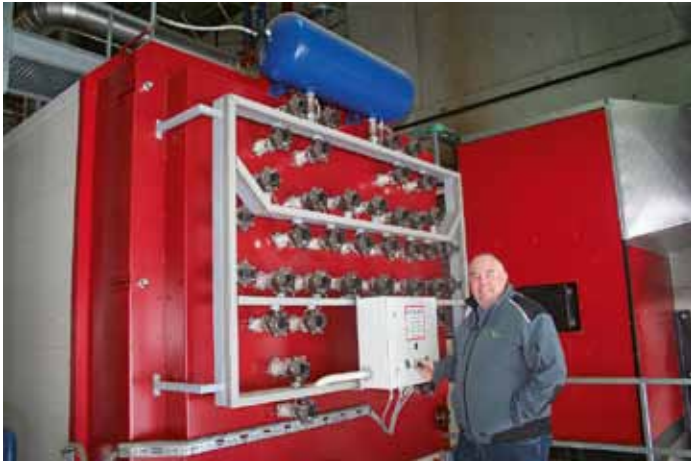
Zufrieden mit der Anlage: Die Kesselreinigung erfolgt automatisch mittels Druckluft, informiert Georg Stampfer
